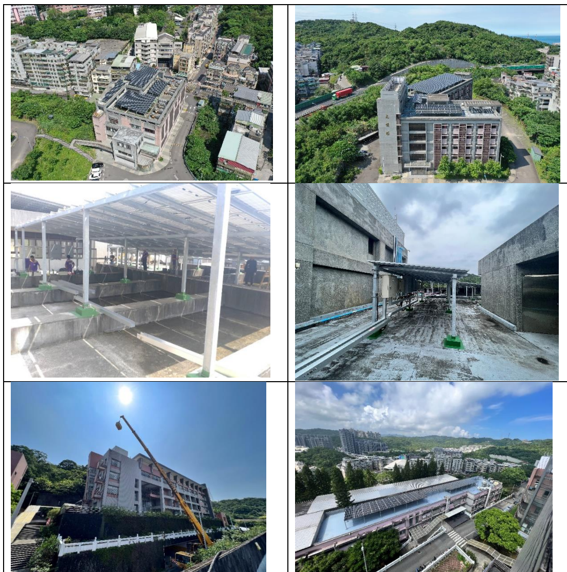
照片 1:太陽能屋型設備
