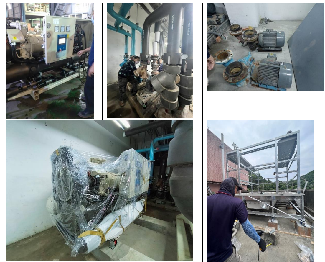
照片 2:冰水主機建置
