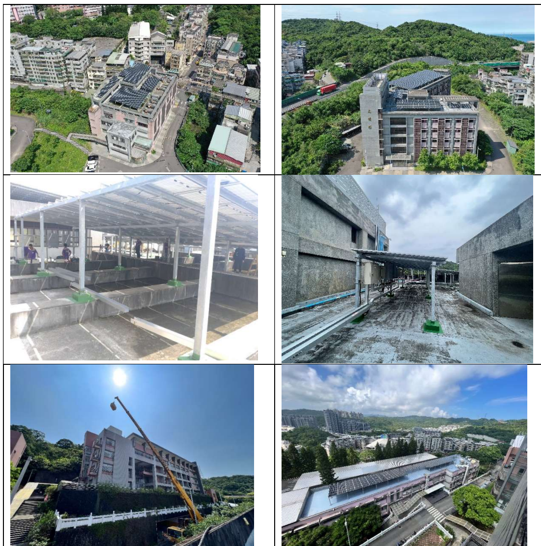
照片 1:太陽能屋型設備
