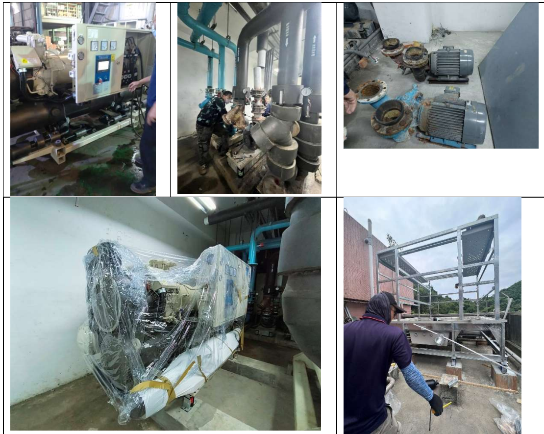
照片 2:冰水主機建置
